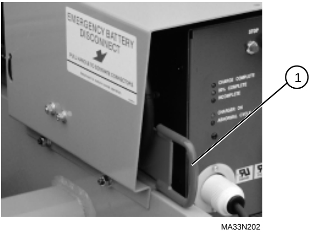
Figure 2-2A. 350 Amp Battery Connectors (SJKB-33N)
